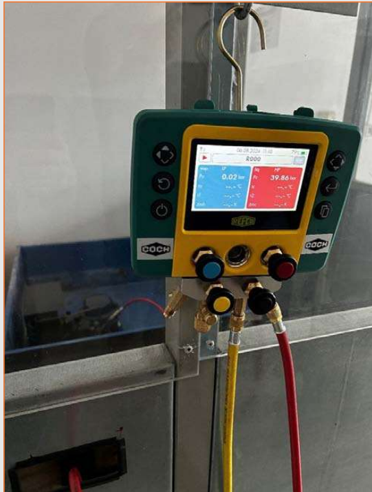
Rys. 5. Urządzenie w trakcie badań ciśnieniowych (źródło: materiały COCH)
